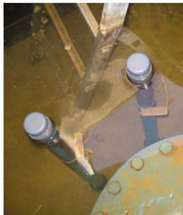
Afb. 3 Putkelder vol water (foto Brabant Water). Doordat de peilfilters voldoende hoog zijn afgesteld en voorzien van een waterdichte kap, kan er geen water in de filters stromen.
